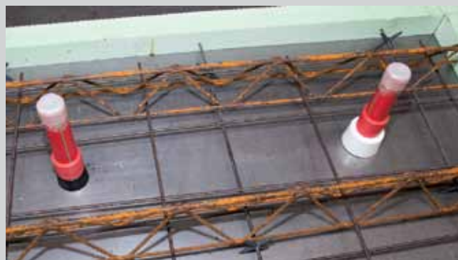
1. Tipo de conexión: rociadores vistos
